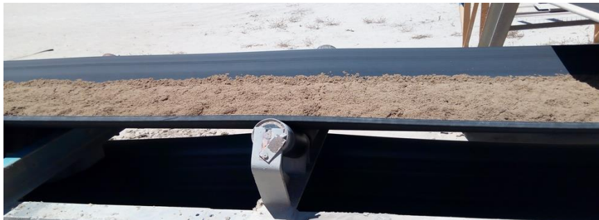
Figure 14: Convoyeur assurant le transport intersites dans le gisement Gantour.
